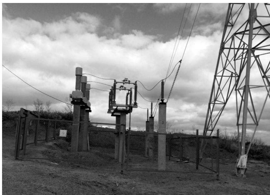
Рис. 2. Трехфазная группа ТОМ для электроснабжения ретранслятора сотовой связи
